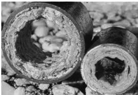
Las incrustaciones internas pueden tapan la cañería.
